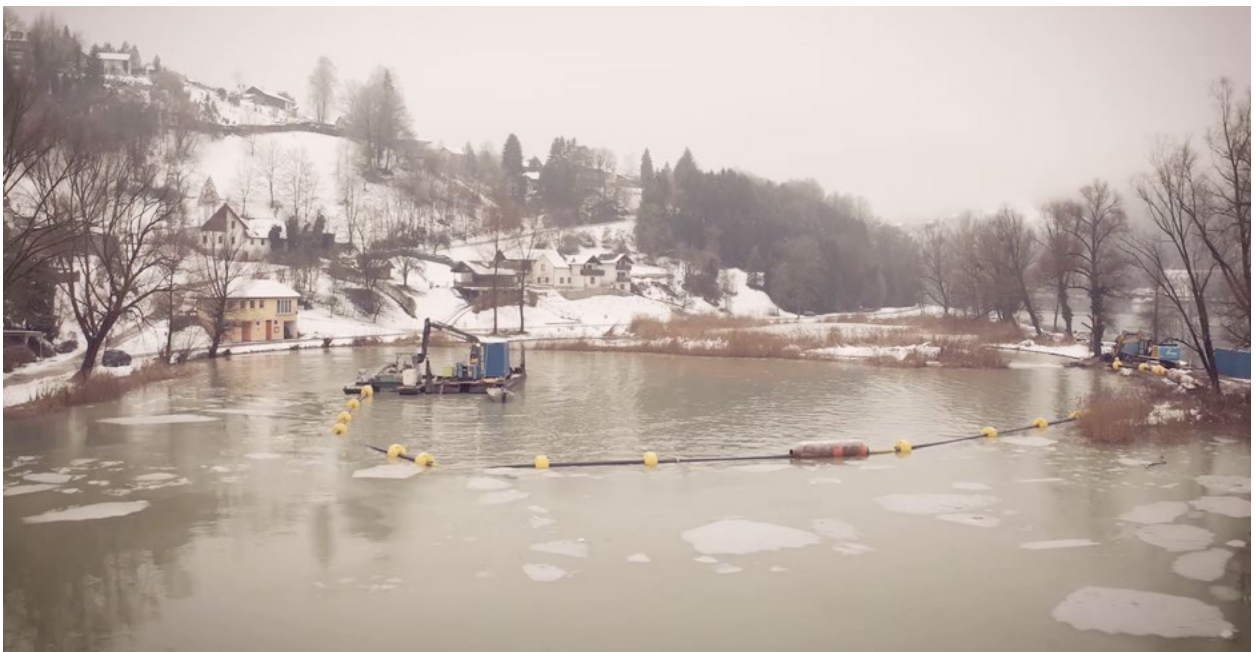
Winterliche Bedingungen 2020/2021 konnten die Entlandungsarbeiten auf den Hößgang-Teichen kaum bremsen. Schließlich galt es, einen wichtigen Wasserlebensraum zu retten.
