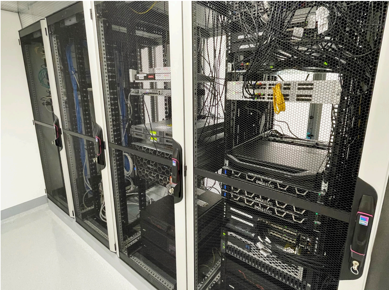
Wie die Zylinder eines Motors. Vier Serrerracks halten den elektronischen Betrieb des Unternehmens in Gang.
