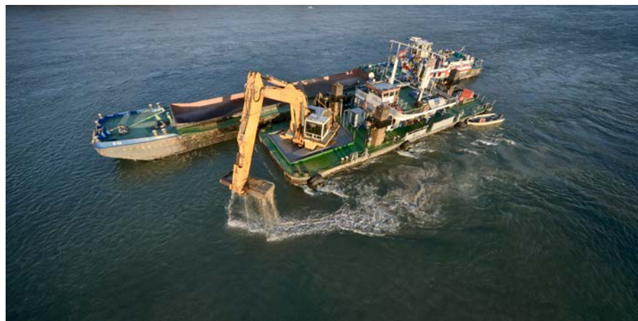
Der im Rahmen der Instandhaltung der Schifffahrtsrinne gebaggerte Kies wird dem Fluss stromauf wieder zugegeben.
