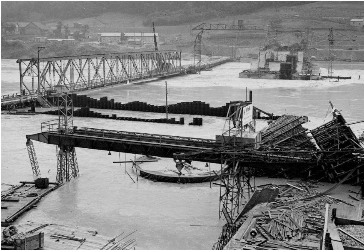
Abbildung 3: Die Baustelle des Ende 1952 begonnenen Kraftwerksprojekts Jochenstein wurde zwar überschwemmt, größere Schäden an den bereits fertiggestellten Bauwerken gab es jedoch nicht. Um die Schäden zu minimieren, wurden die Baugruben durch Sprengung rechtzeitig geflutet. Dies hatte eine längere Unterbrechung der Bauarbeiten zur Folge. (viadonau Aschach)
