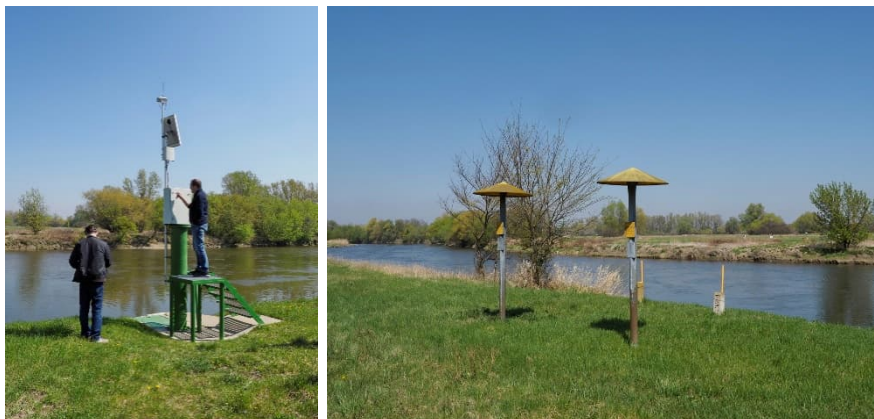
Abbildung 10: Erneuerte Messtation aufgrund Dükerquerung (Markierungen rechts)
