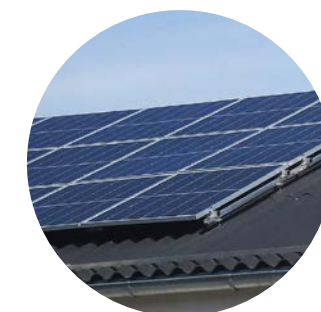
2021 wurde bereits eine Photovoltaik-Anlage am Standort Grein in Oberösterreich in Betrieb genommen.
