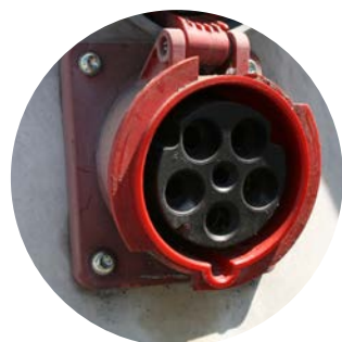
Dank Landstrom kann während des Stillliegens der Schiffe auf Diesel-Aggregate verzichtet werden.
