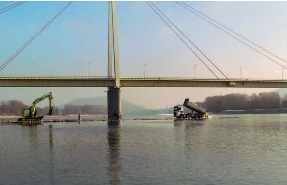
Bei Bad Deutsch-Altenburg wurden zuletzt rund 6 800 Tonnen Wasserbausteine in fünf Bühnen eingebaut, um 2,5 Meter Fahrwassertiefe zu ermöglichen.
