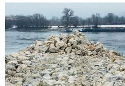
Um die Befahrbarkeit auch bei Niedrigwasser zu gewährleisten, wurden in Bad Deutsch-Altenburg Buhnen aufgehöhht.
